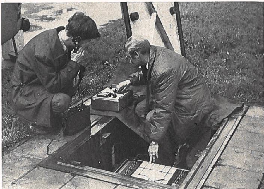
Een versterkerbak waarin de tussenversterkers op een interlokale kabelroute zijn ondergebracht.
